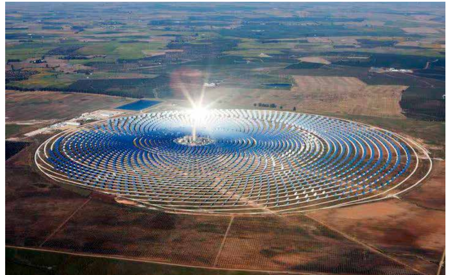
Nærkontakt av tredje grad. Tusenvis av enorme speil reflekterer solens stråler mot et høyt tårn ved riksvei 475 i Andalusia. Solkraftverket Gemasolar produserer strøm nok til 2 milliarder vaskemaskin-omdreininger i året.
